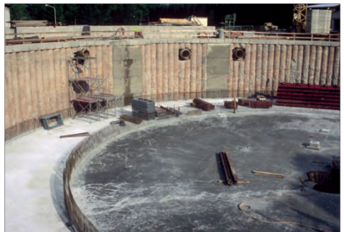
Kläranlage Illingen-Wustweiler: neuer Zustand
